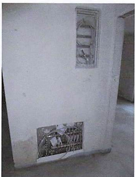
17. Installationen Elektrik, Fußbodenheizung
