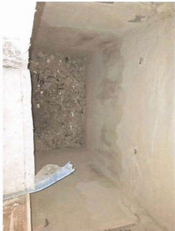
Foto 4 Deutlich erkennbarer Feuchtehorizont am Putz des Aufzugsschachts. Auf dem Boden des Schachts ist vollflächig Bauschutt verteilt.
