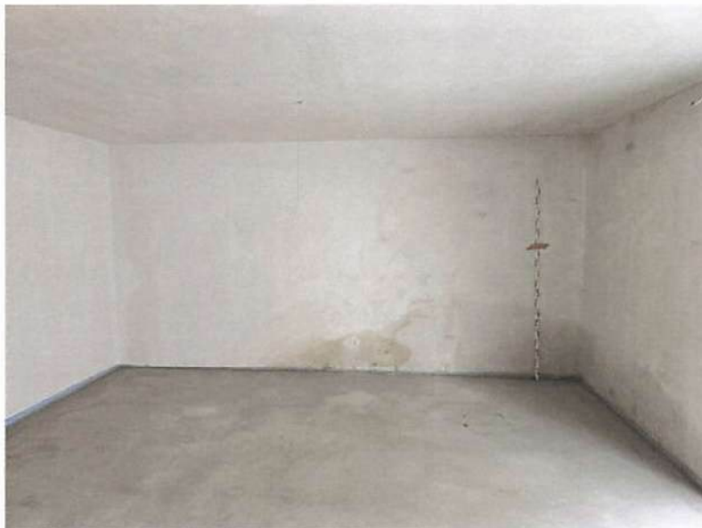
Foto 29 Wohnung 2 im EG, Blick auf die südliche Gebäudetrennwand. Deutlich sichtbar ist die Feuchtigkeit im Wandputz im unteren Bereich der Süd- und der Westwand.
