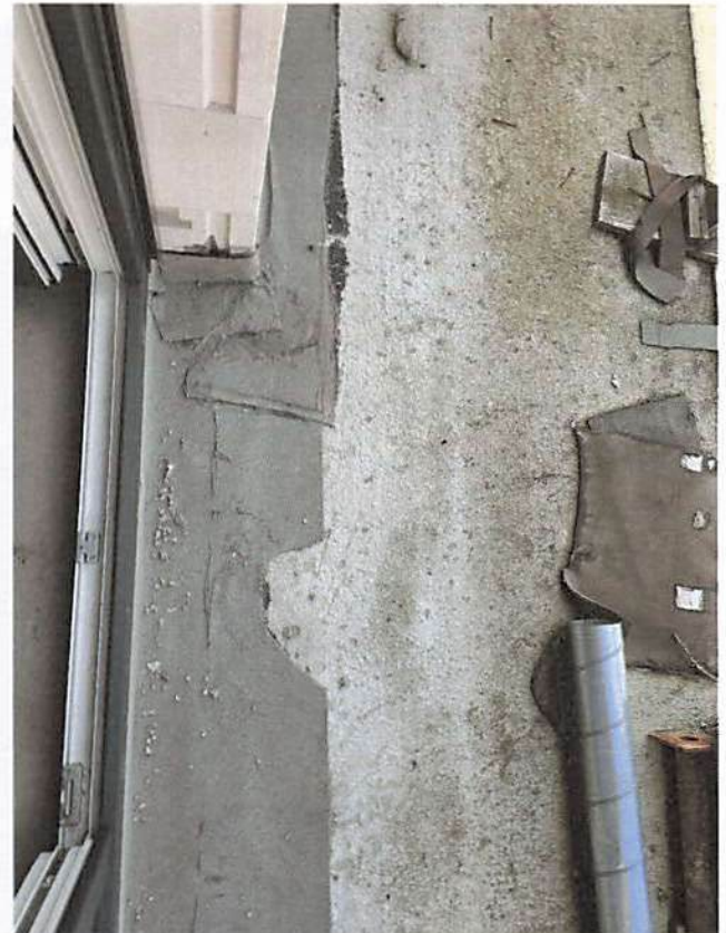
Foto 57 OG, Whg 3, Balkon Nord, Detailaufnahme. Abdichtung am Balkon auf der Nordseite.
