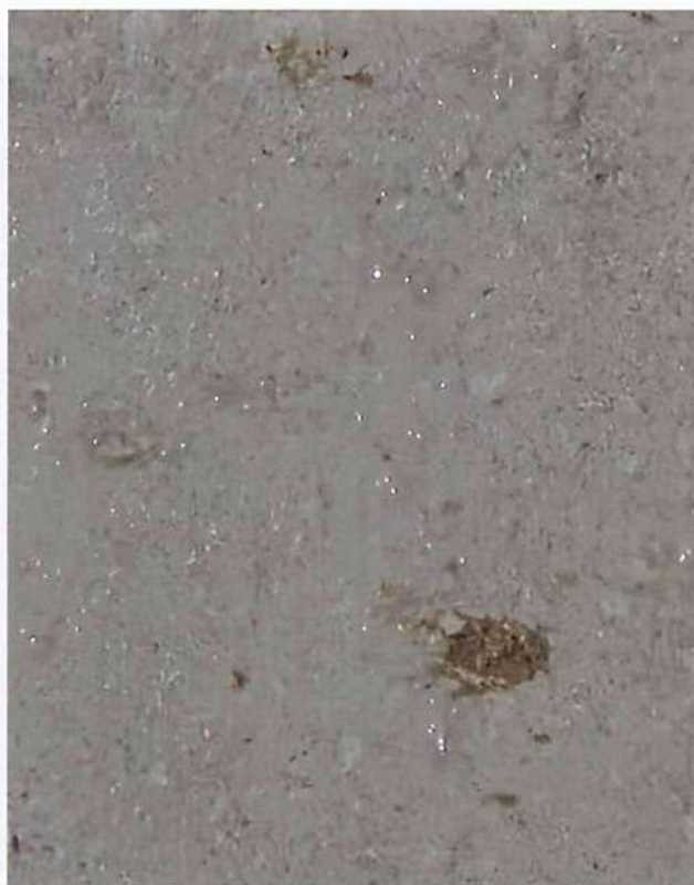
Foto 36 Ausschnittvergrößerung. Deutlich zu erkennen Wassertropfen an der Wandoberfläche.
