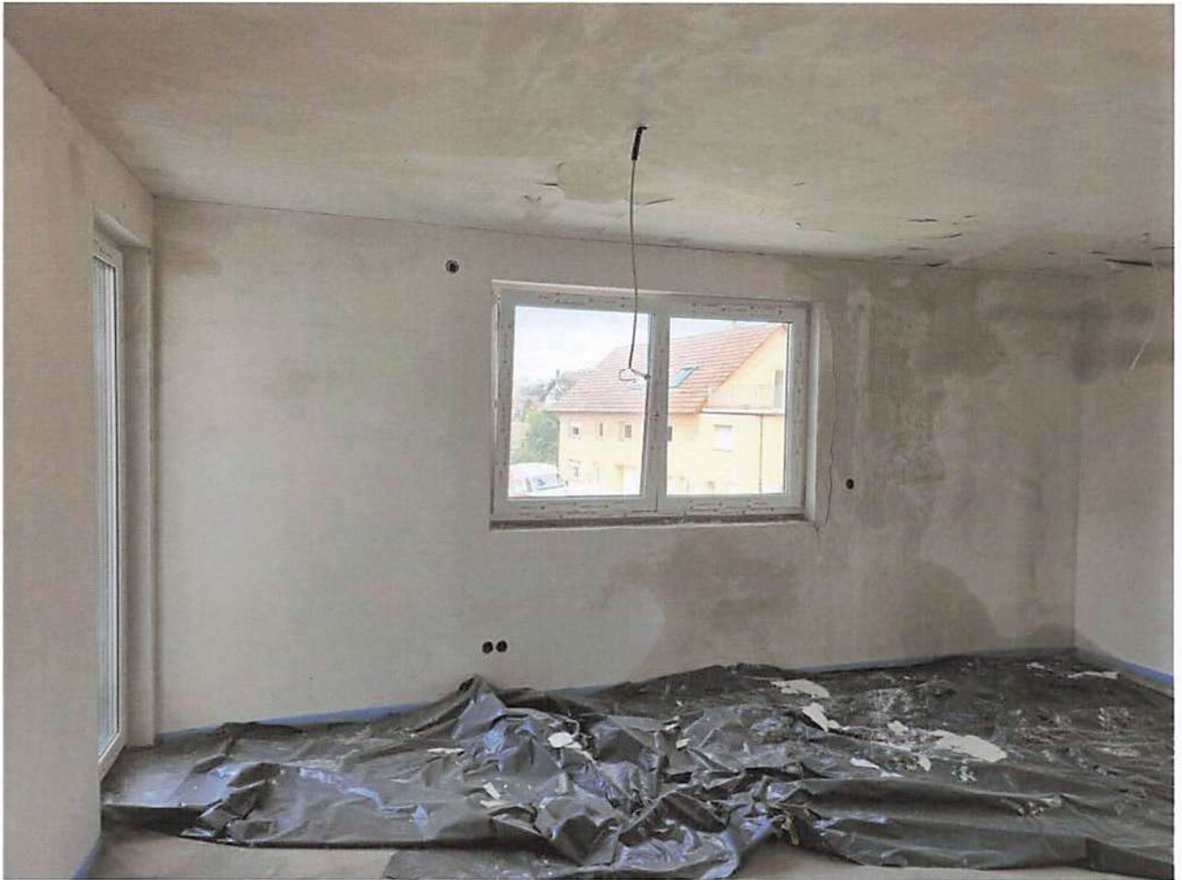
Foto 39 Obergeschoss, Whg. 3, Wohnen/Essen/Kochen, Nordwand. Die Außenwand ist deutlich durchnässt, auch der nördliche Teil der Deckenspachtelung. Darüber liegt eine nicht abgedichtete Terrassenfläche.
