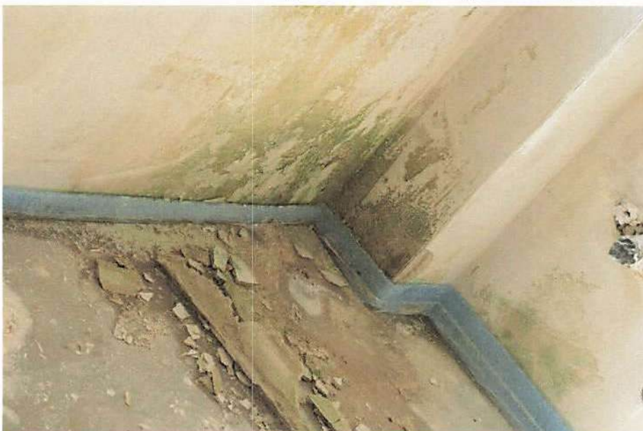
Foto 51 Whg. 4, OG, Küche, Westwand (links) und Nordwand (rechts), Installationsschacht. Deutliche Spuren von Durchfeuchtung und unten grüner biogener Besatz. Auf dem Boden von der Decke herabgefallene Deckenspachtelung.
