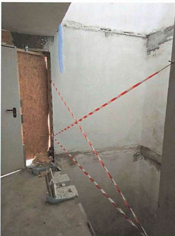
Foto 1 Treppenhaus Erdgeschoss, links im Bild die provisorische Haustür. Im Vordergrund die Markierung des Treppenschachts mit Trassenband. Es ist keinerlei Absturzsicherung festzustellen.
