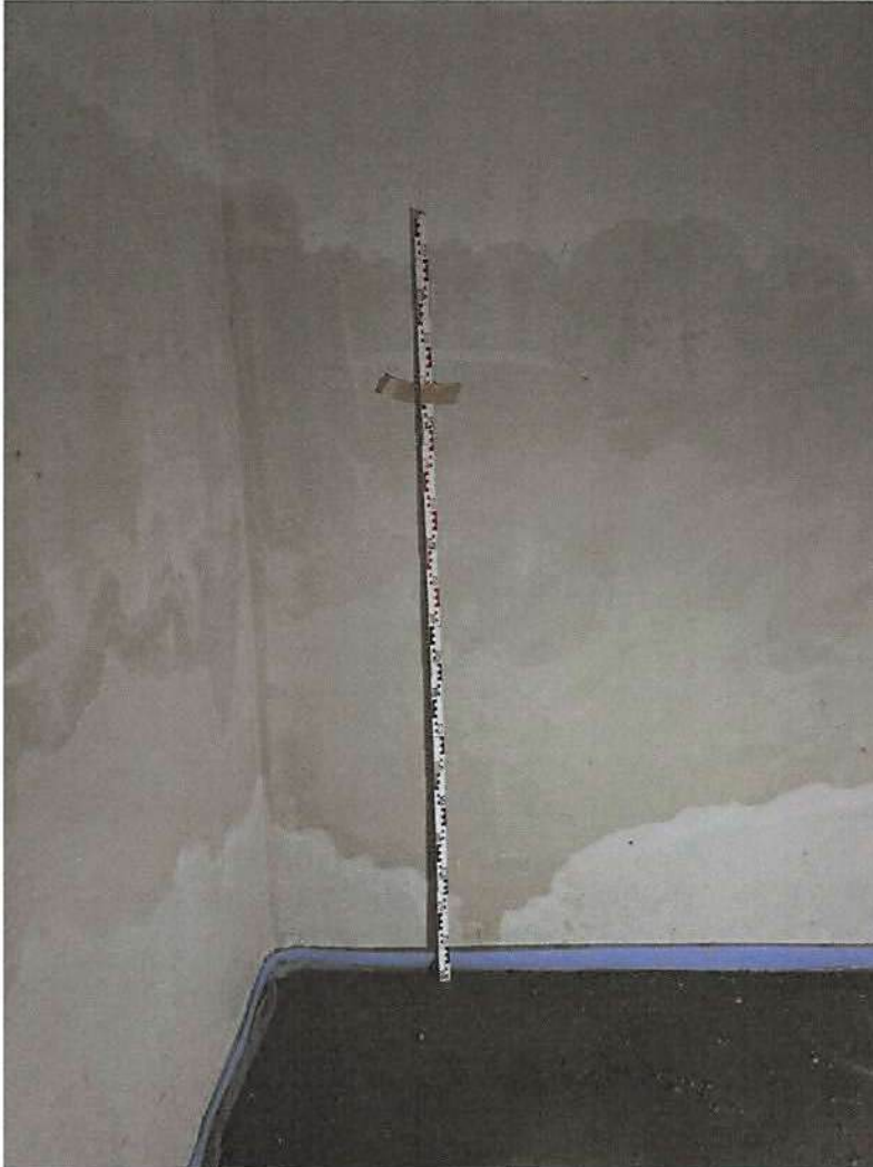
Foto 33 UG, Treppenhaus, Nordwand. Die Feuchtigkeit ist deutlich zu erkennen.
