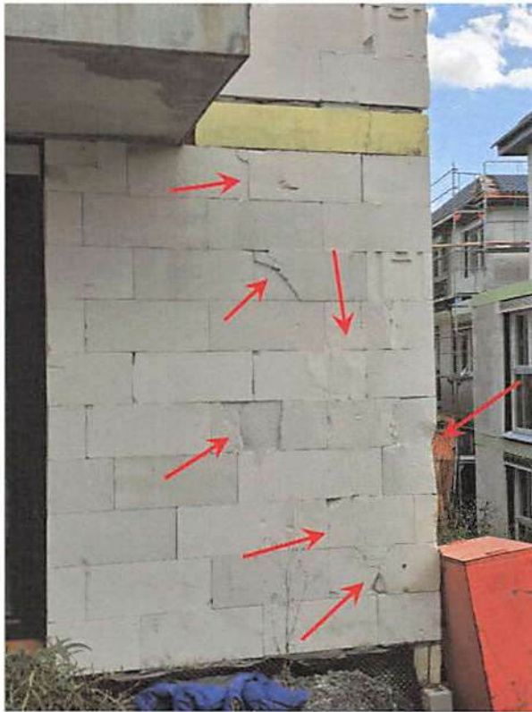
Foto 20 Nordwestecke des Gebäudes, Blick auf die Nordseite. Das Schadensbild deutet darauf hin, dass hier ein Anprall einer Baumaschine oder eines LKWs stattgefunden hat.
