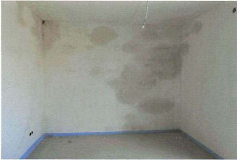
Foto 43 Whg. 3, OG, Schlafzimmer, Westwand. Deutliche Anzeichen von Feuchtigkeit.
