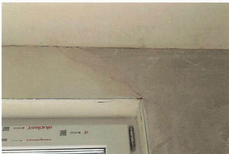
Foto 45 Whg. 4, OG, Westwand Wohnen/Essen. Rechts neben und über der Balkontür deutliche Spuren von Durchfeuchtung. Risse in der Putzfläche / Wand.
