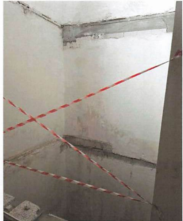
Foto 8 Auf der Innenseite sind deutliche feuchte Bereiche am Innenputz festzustellen.
