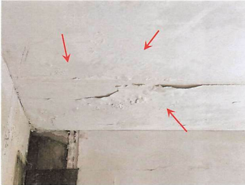
Foto 55 Whg. 4, OG, Wohnen/Essen, Westwand. Flächig abgelöste Decken- spachtelung in dem Bereich, wo im Geschoss darüber ein Balkon angeordnet ist.
