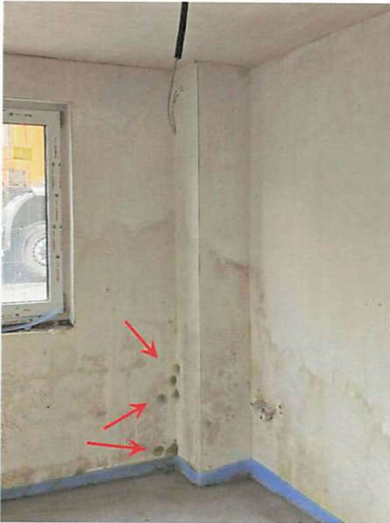
Foto 15 In Wohnung 1, an der südöstlichen Raumecke des Raumes Wohnen / Kochen / Essen, sind an der Außenwand, angrenzend an den Installationsschacht, deutlich grüne / grünliche biogene Beläge festzustellen.
