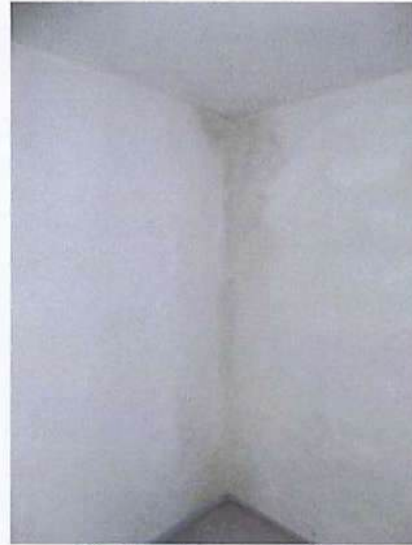
20. Feuchte von außen
