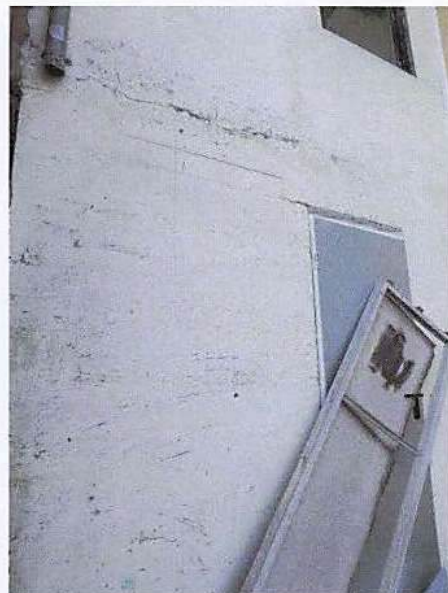
4. Westseite Zwischenbau (Risse)
