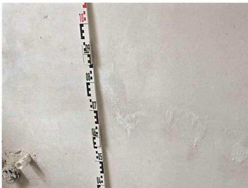
Foto 30 Exemplarisches Foto für deutlich sichtbare Ausblühungen am Innenputz, hier in Whg. 2 im EG, Küche, Nordwand.
