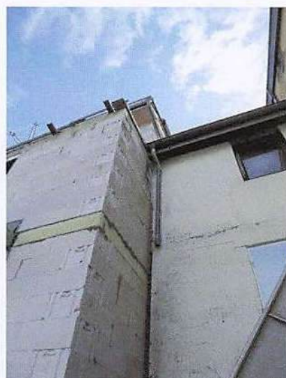
6. Westseite Zwischenbau (Feuchte)
