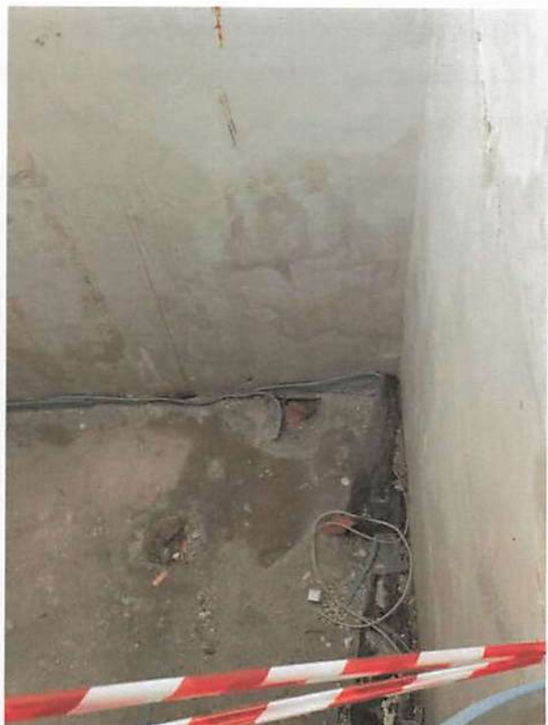
Foto 6 Feuchte Flecken auf dem Estrich des Treppenschachts im UG.
