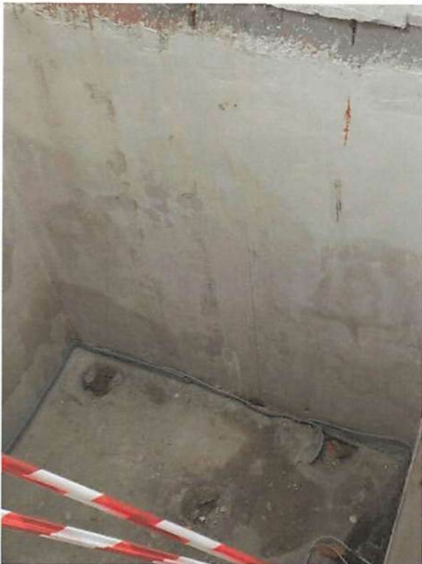
Foto 5 Boden des Treppenschachts im UG. An den Wänden sind verschiedene Feuchtehorizonte mit visuell erkennbar unterschiedlicher Feuchteintensität erkennbar.
