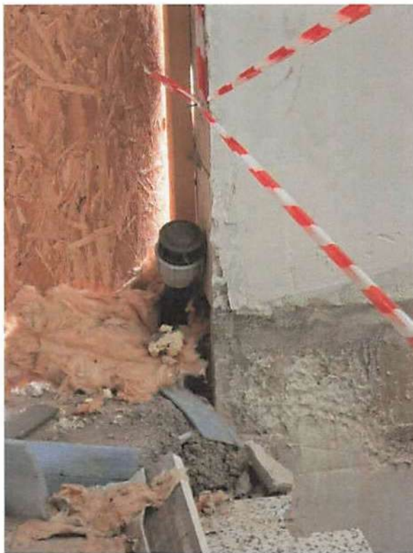
Foto 3 Frischwasserzuleitung, provisorisch in den Bereich der provisorischen Haustür verlegt. Dieser hatte nach Angaben des Verwalters in der Vergangenheit eine Leckage.
