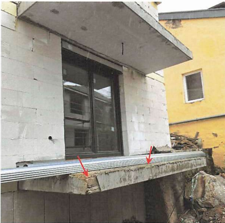
Foto 22 Beschädigungen an den Abstellkanten der Balkonplatte im Erdgeschoss.
