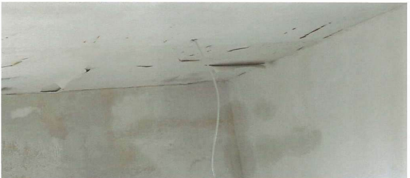
Foto 40 Bildausschnitt Deckenfläche. Die Deckenspachtelung hat sich flächig abgelöst.
