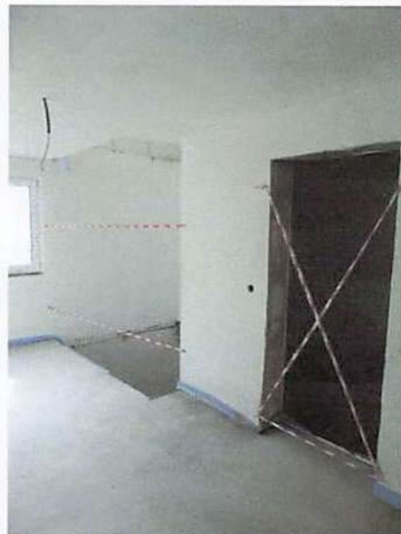
28. Blick zum Treppenhaus und Aufzugsschacht (überall fehlende Geländerabsicherungen)
