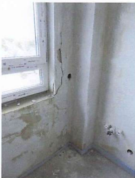
23. OG Küche Feuchte von außen (Balkon 2. OG)
