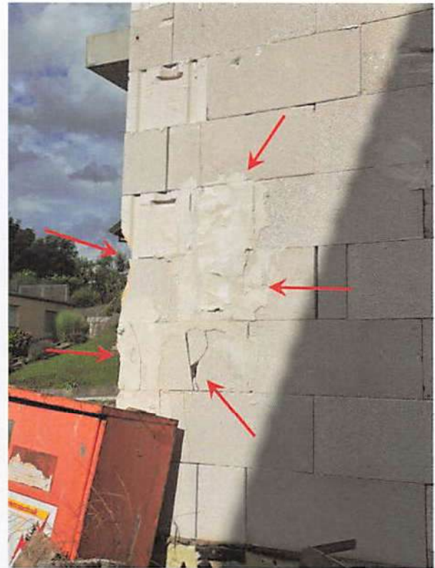
Foto 21 Nordwestecke des Gebäudes, Blick auf die Westseite. Das Schadensbild deutet darauf hin, dass hier ein Anprall einer Baumaschine oder eines LKWs stattgefunden hat.
