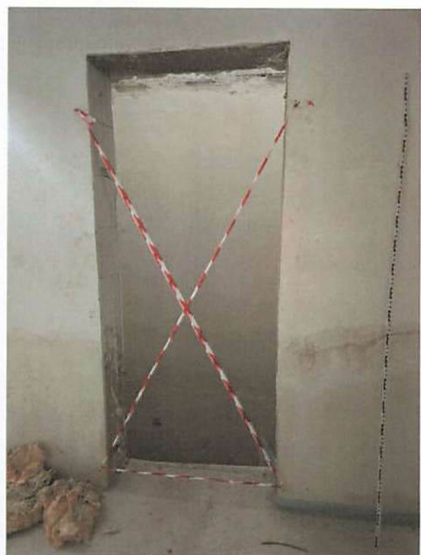
Foto 2 Tür zum Aufzugsschacht Auch hier nur eine Markierung durch Trassenband. Keine Absturzsicherung.
