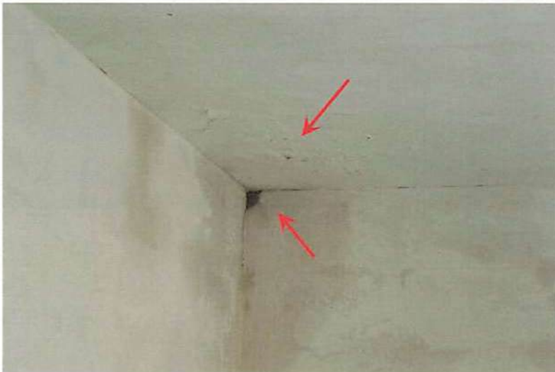
Foto 44 Detail Raumecke oben links. Es liegt grünlicher biogener Befall vor. Die Deckenspachtelung hat sich entlang der Westwand flächig abgelöst.
