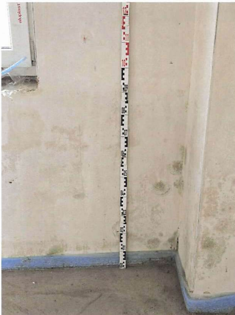
Foto 28 Exemplarische Stelle in der Küche von Wohnung 1 im EG. Darstellung einer Messachse zur Aufnahme der Materialfeuchtigkeit des Innenputzes.
