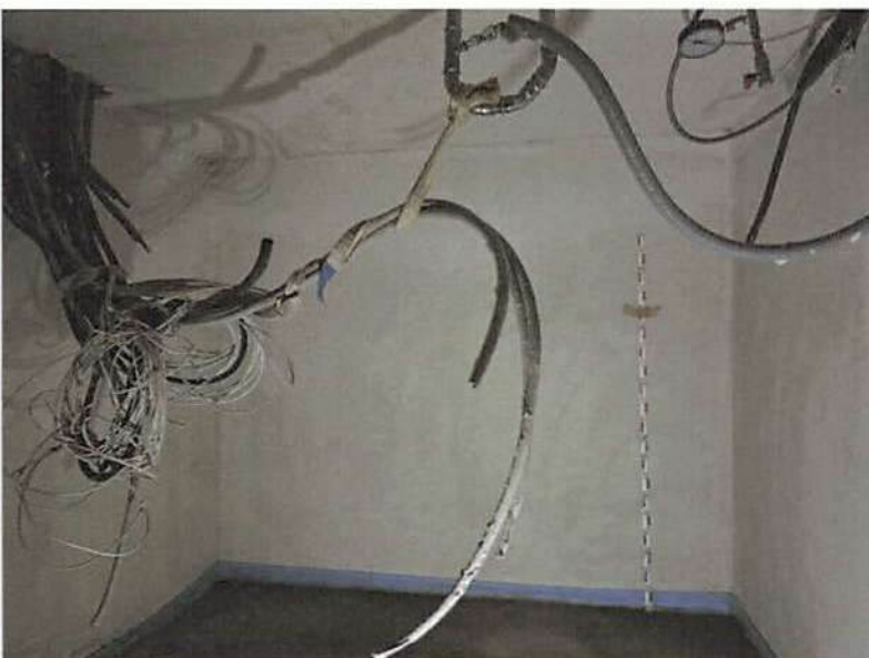
Foto 32 UG, Heizraum. Die Feuchtigkeit in den Wänden ist anhand der Dunkelverfärbung deutlich zu erkennen.
