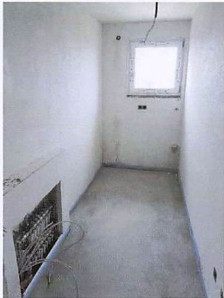
33. Abstellraum 2. OG (Feuchte von außen)
