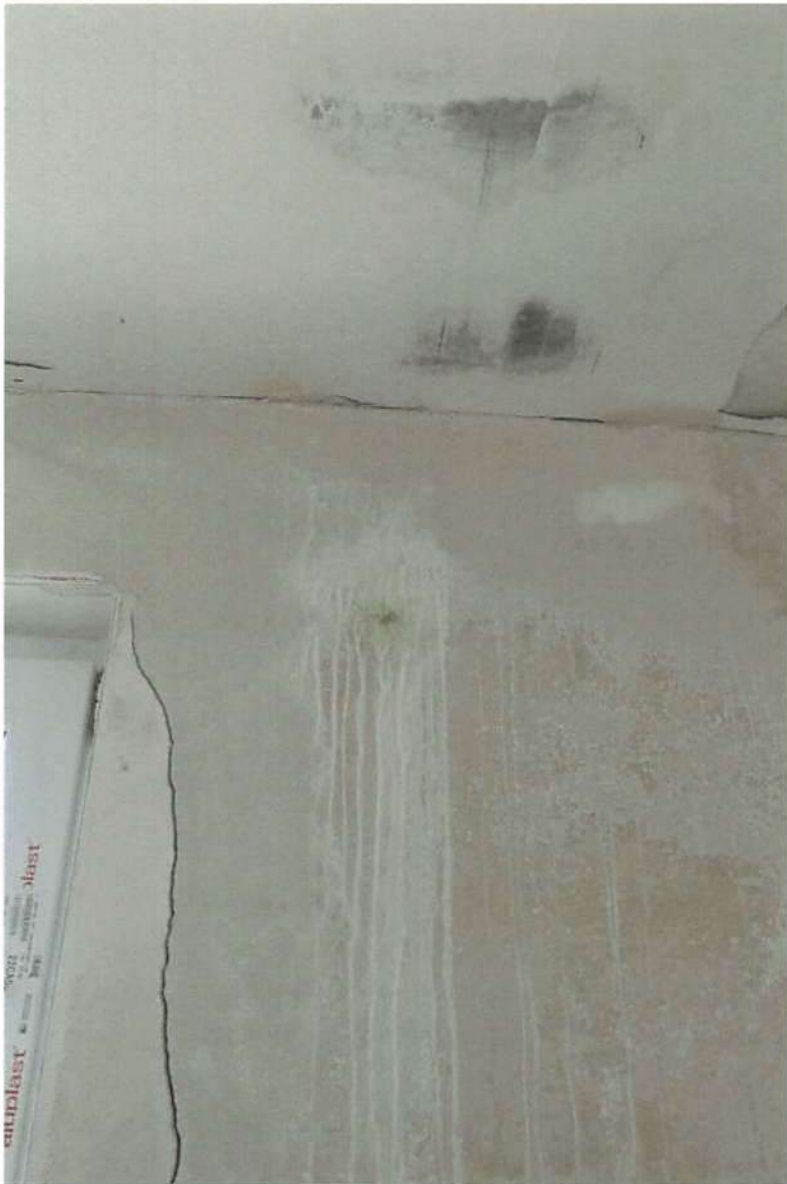
Foto 41 Nahaufnahme Nordwand, Bereich rechts neben dem Fenster.
