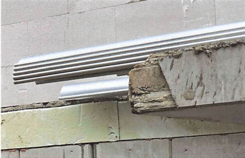
Foto 24 Detailaufnahme des Schadens an der vorderen Ecke des westseitigen Balkons im Erdgeschoss.
