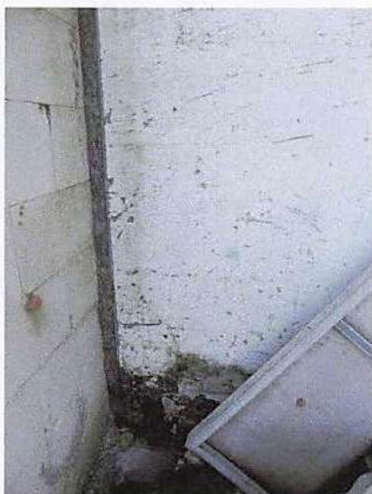
5. Westseite Zwischenbau (Feuchte)
