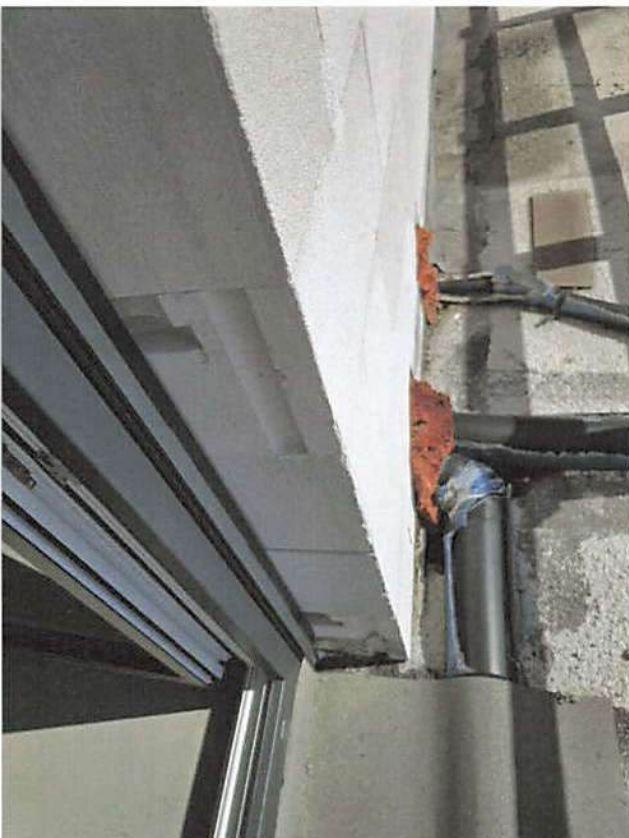
Foto 58 (links oben) OG, Whg 3, Balkon Nord, Blick nach Osten. Auch hier nicht fachgerecht ausgeführte Wand-/Boden-Abdichtung.
