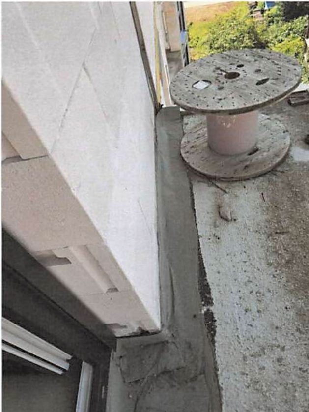
Foto 56 OG, Whg 3, Balkon Nord, Blick nach Westen. Nicht fachgerecht ausgeführte Wand-Boden- Abdichtung am Balkon auf der Nordseite.
