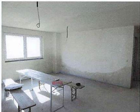
13. Aufsteigende Feuchte (verursacht durch tropfende Wasserleitung)
