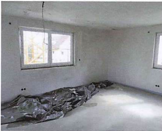
27. Feuchte Wand, Decke, Fußboden vom Balkon 2. OG
