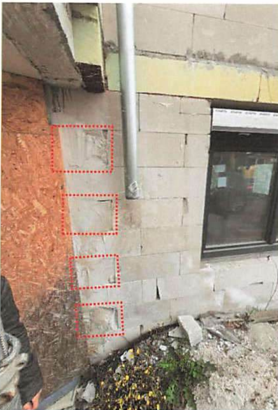
Foto 18 Fallrohr rechts von der Haustür. Der Befund deutet auch darauf hin, dass zurückliegend zeitweise ein Mauerpeiler vorhanden war, der kein eigenes Fundament hatte, aber mit dem bestehenden Außenmauerwerk verzahnt war.
