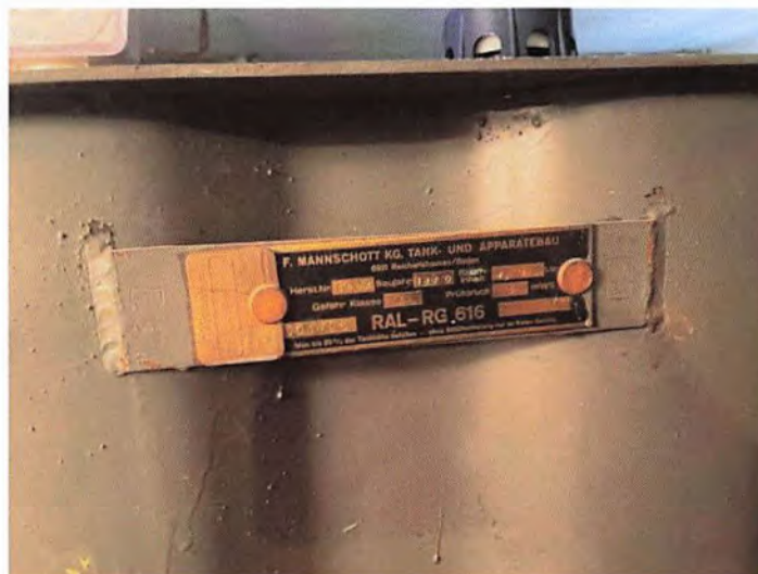
Bild 14: Stahltank im Gebäude (Baujahr 1970)
