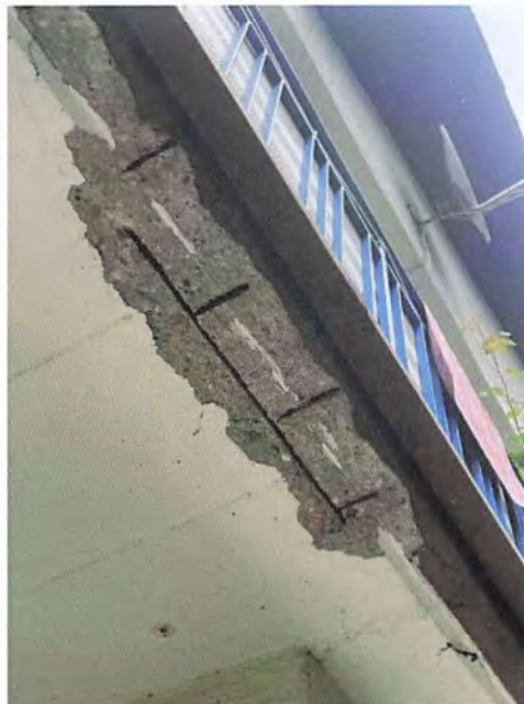
Bild 8: Detailaufnahme Betonschäden an der Balkonplatte
