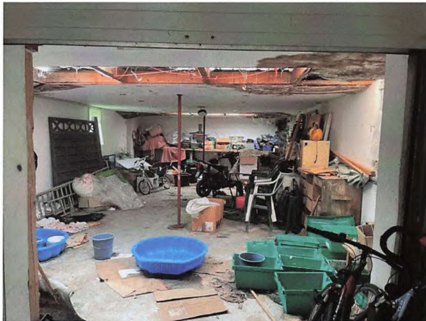
Bild 12: Anbau an/über Garage Innenansicht EG (sichtbare Stütze/vermutlich mangelhafte Statik)
