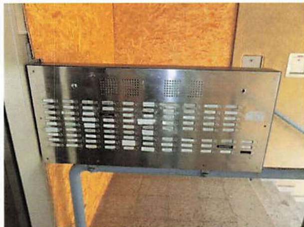
Klingel- und Gegensprechanlage | Blücherstraße 3
