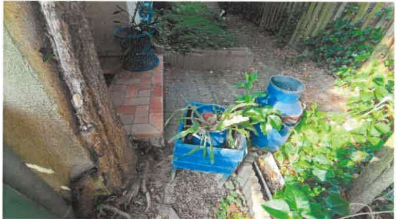
Beispiel für Bau- schäden infolge des Pflanzenbewuchses, hier: nördliche Haus- ecke
