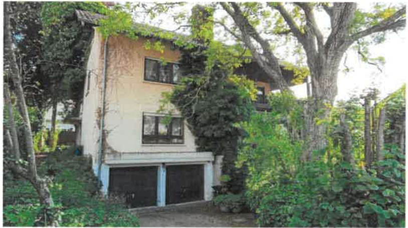
Beispiel für Pflanzenbewuchs an Fassaden im Dachbereich
