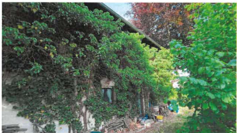
Beispiel für Pflanzenbewuchs, hier: Fassade und Dachüberstand auf nordöstlicher Traufseite
