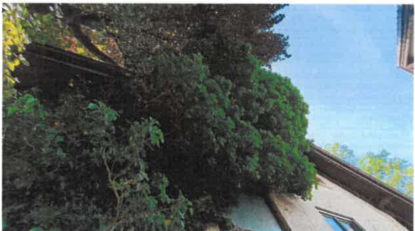
Beispiel für Pflanzenbewuchs, hier: Fassade auf nordwestlicher Giebelseite, Ortgang
