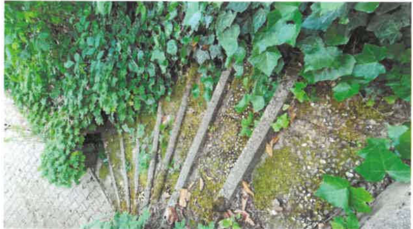
Schäden an Treppe zum Hauseingang auf der nordwest- lichen Giebelseite
