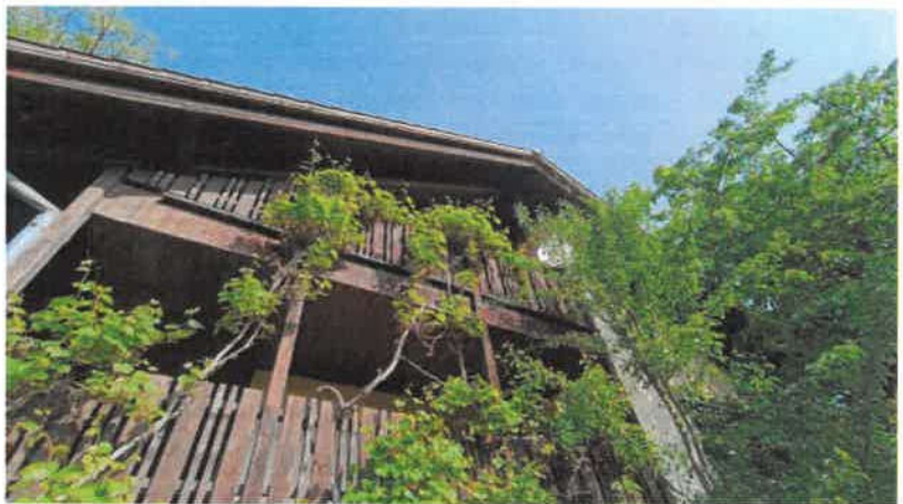
Beispiele für fehlenden Holzschutz, hier: Balkone an südlicher Hausecke
