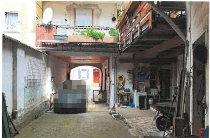
Ansicht von Scheune auf Hof und südöstlichen Teil des Hauptgebäudes/ Wohngebäudes mit Anbau
