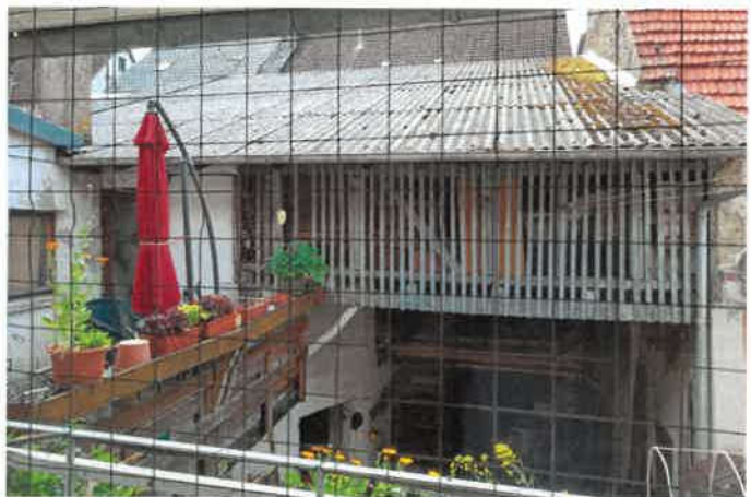
Ansicht von Obergeschoss des Hauptgebäudes (Schlafzimmer) auf nordwestlichen Teil der Scheune mit Anbau
