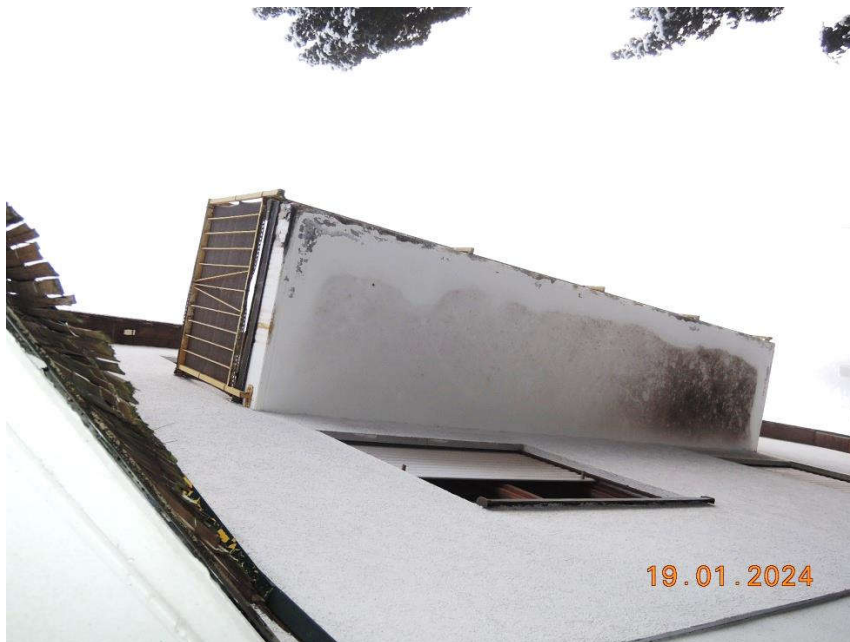
Bild 11: Feuchtigkeitsschäden Balkon im Dachgeschoss
