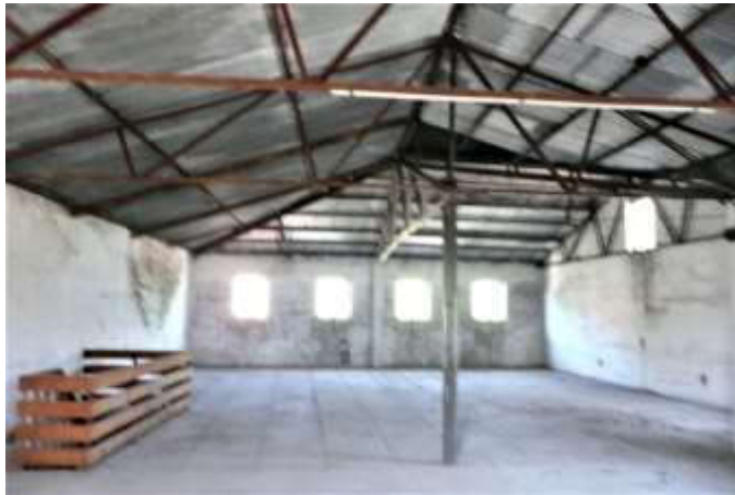
Obergeschoss, starke Feuchtigkeitsschäden
