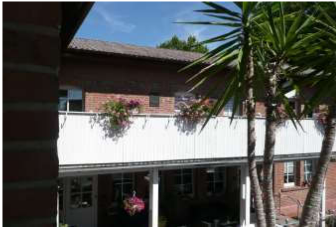
Balkonbrüstung Obergeschoss, massive Feuchtigkeitsschäden
