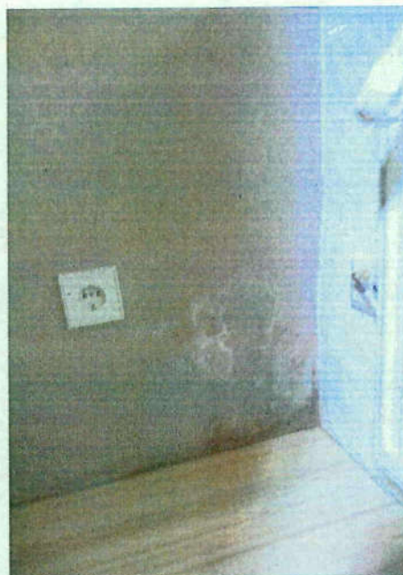
aufsteigende Feuchtigkeit in der Einliegerwohnung
