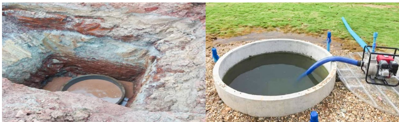
ลักษณะธนาคารน้ำใต้ดินระบบบ่อห้ศจรรย์กูอินวัน แบบใส่ท่อวงเดียว
