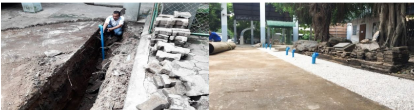
ลักษณะธนาคารน้ำใต้ดินระบบบ่อปิด รูปแบบรางระบายน้ำเดิม
