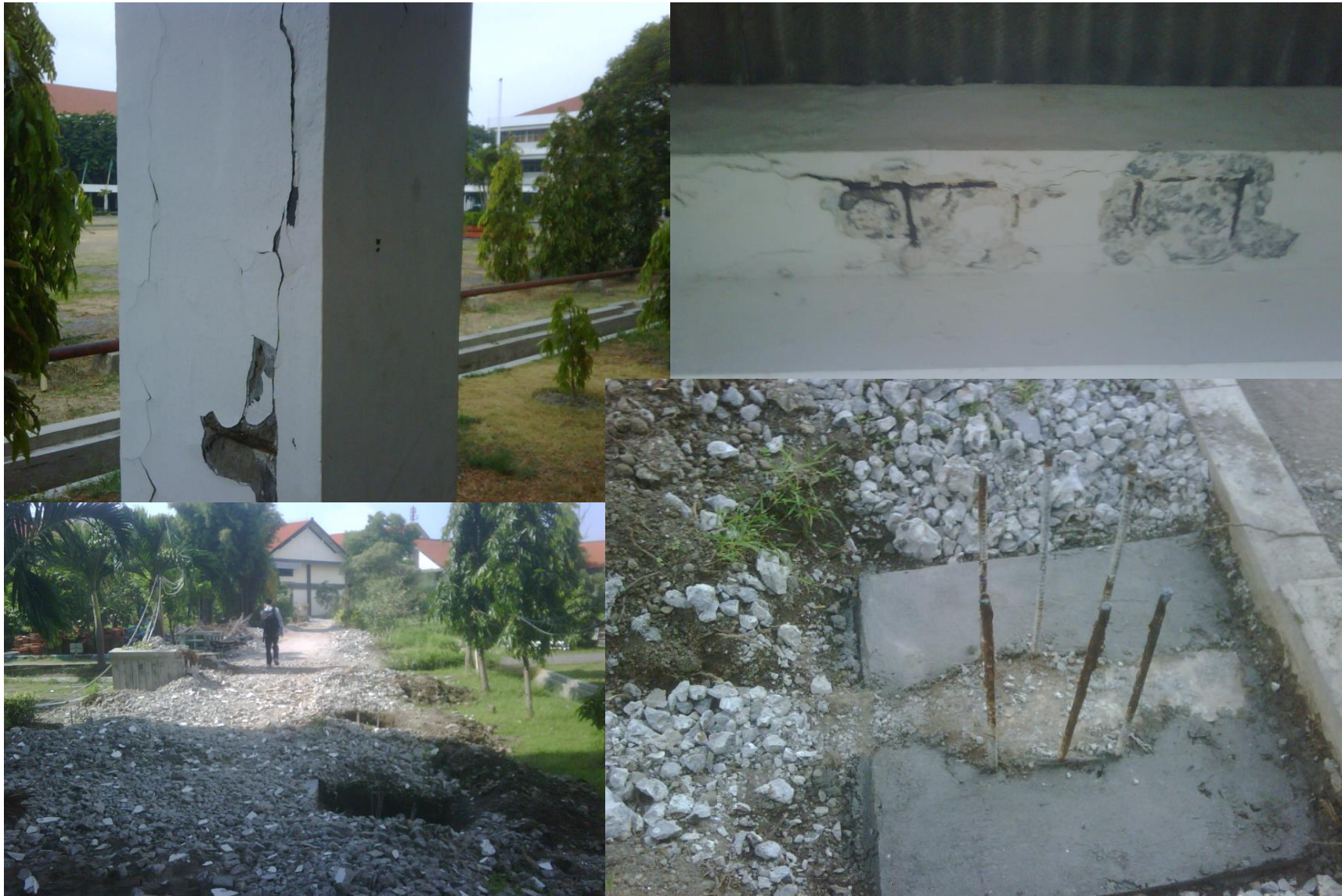
Korosi pada struktur dengan umur <10 tahun (belum runtuh sudah dibongkar)
