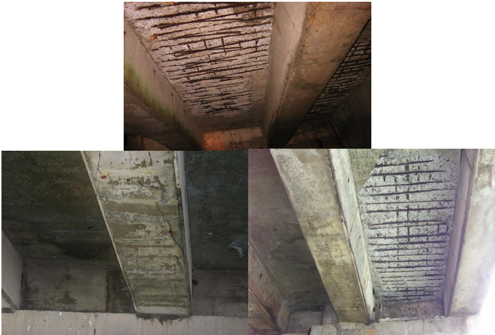
Korosi pada jetty dengan usia 20 tahun
