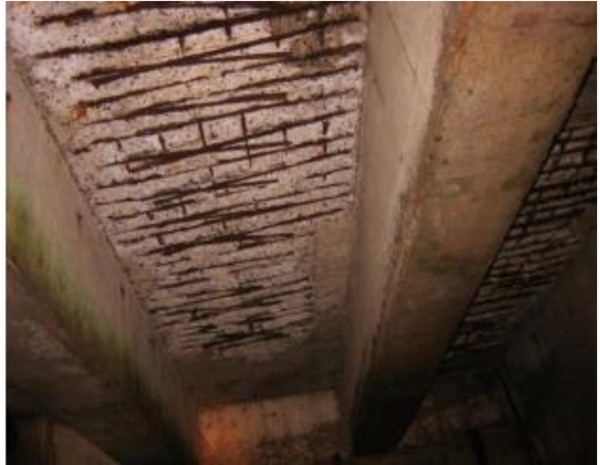
Gambar : Korosi pada tulangan pelat dermaga yang menyebabkan selimut beton terkelupas.
