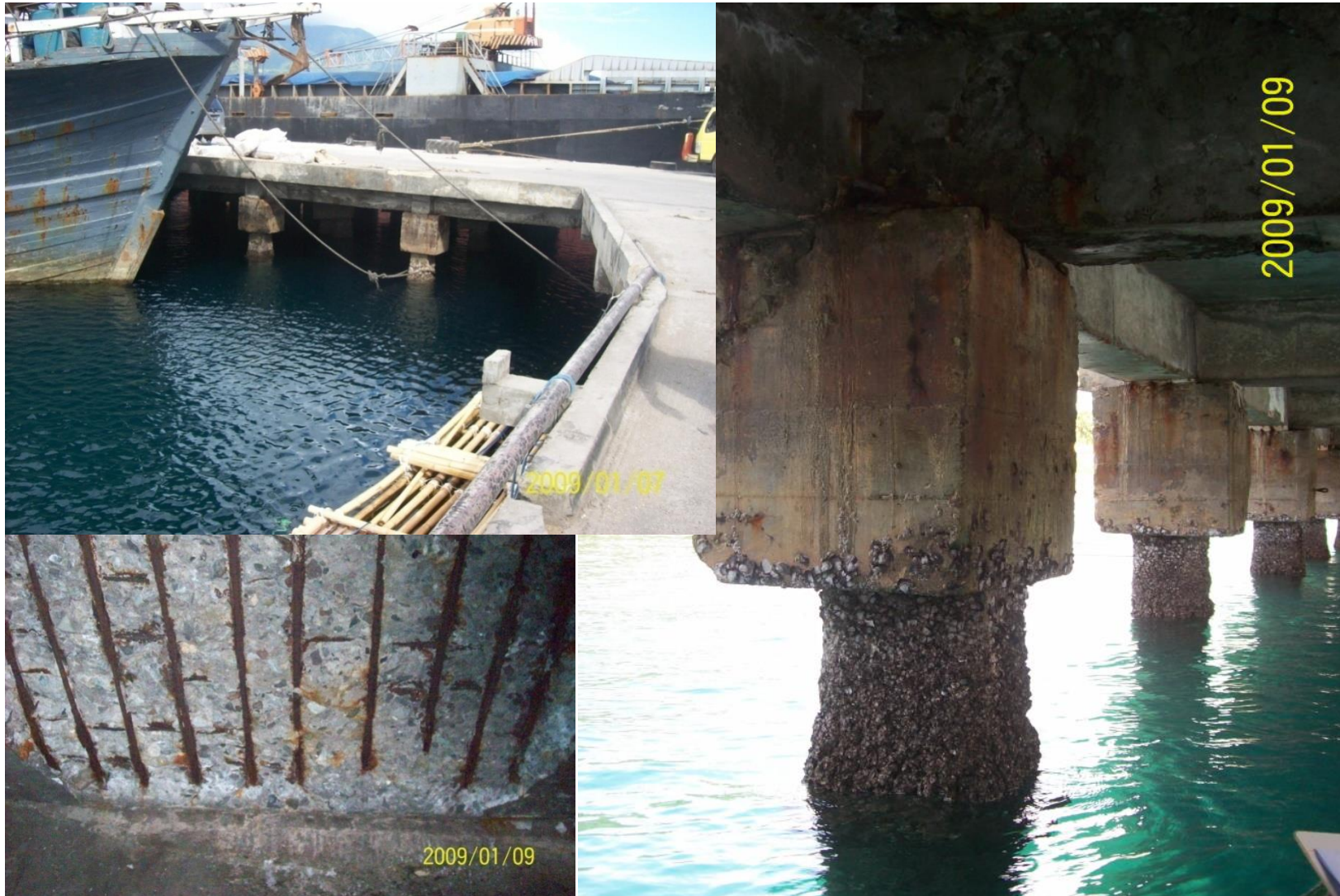
Korosi pada jetty dengan usia 25 tahun
