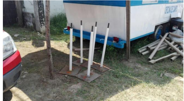
Figure 15. Placas de asiento para monitorear los asentamientos posteriores a la colocación de la precarga.
