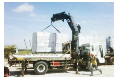
PUESTA EN MARCHA DE EQUIPOS DE CONGELAMIENTO
