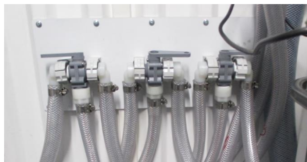
Figur 22 Ventilsett Avløp på frontvegg
