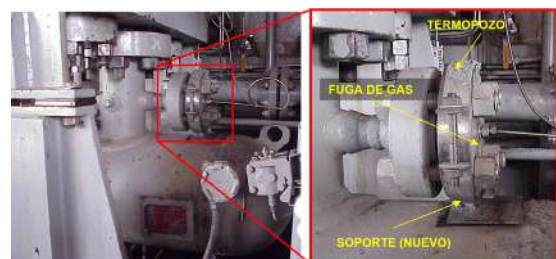
Figura 1c. Registro fotográfico del área donde se detectó la fuga de gas
