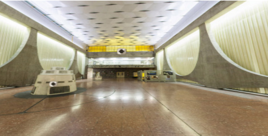
Fotografía 1. Central hidroeléctrica de Susqueda-Girona (España). Fuente: Endesa Generación-Enel Green Power Hydro.
