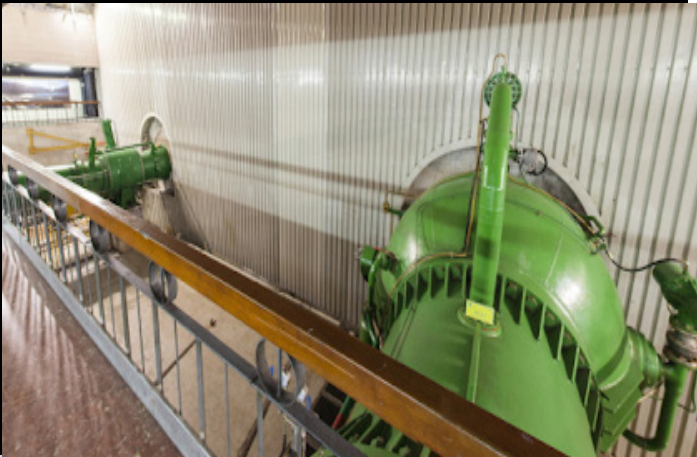
Fotografía 3. Planta válvulas central hidroeléctrica de Susqueda-Girona (España). Fuente: Endesa Generación-Enel Green Power Hydro.
