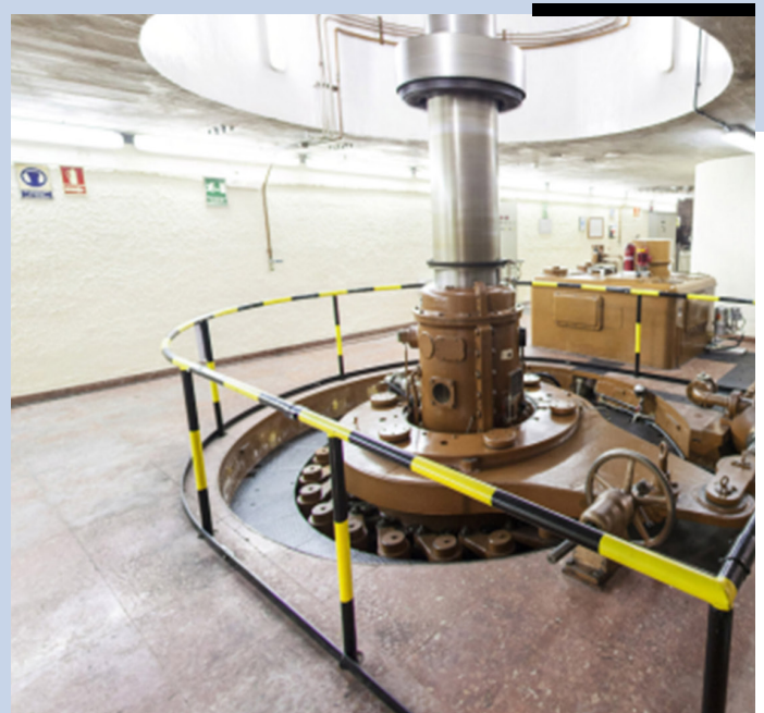
Fotografía 2. Planta turbinas central hidroeléctrica de Susqueda-Girona (España). Fuente: Endesa Generación-Enel Green Power Hydro.
