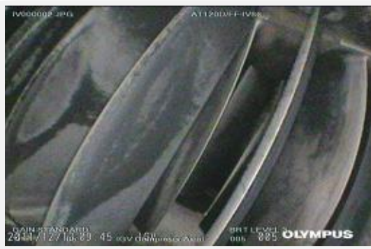
Fig.5. Inlet Guide Vanes (IGV's) succión compresor axial
