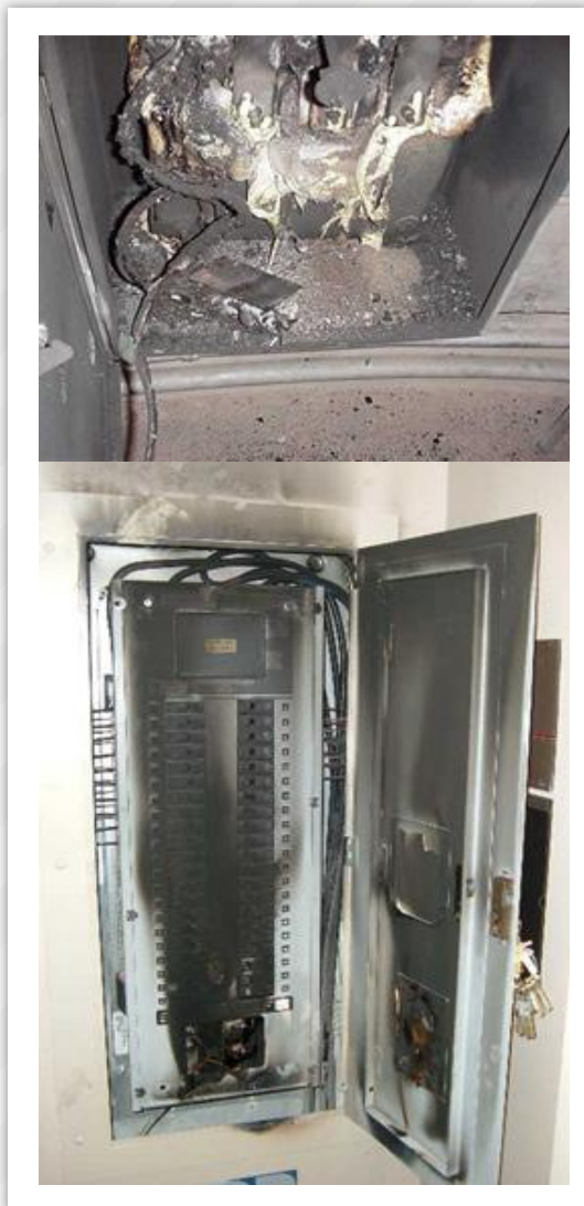
Fotos: Problemas en protecciones que terminan generando incendios en tableros. [8]
