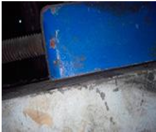
Fotografías que ilustran la presencia de la pata coja en el caso de estudio (Fotos tomadas por el autor).
