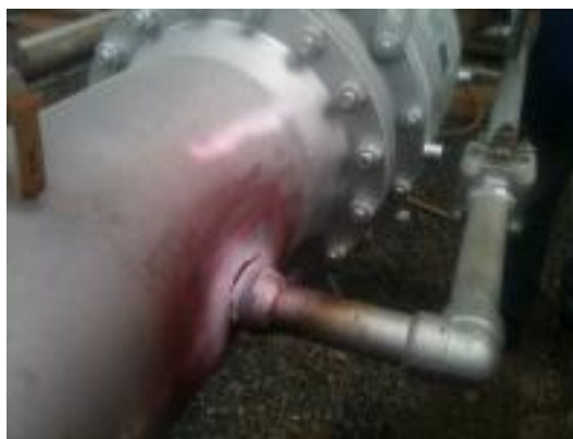
Img.01.- Falla por Grieta longitudinal en sistema de tuberías entrada unidad compresora PC Jusepín 12 PDVSA CGO
