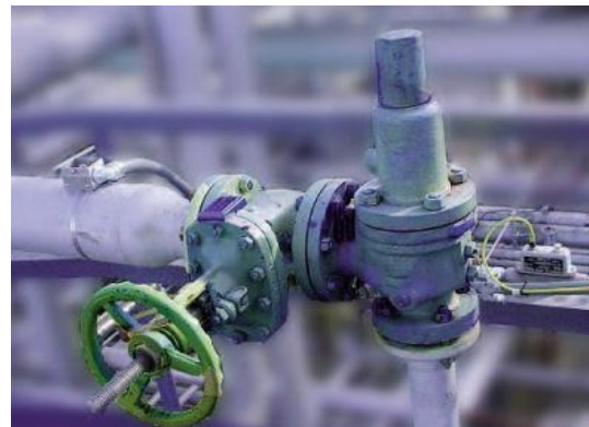
Ilustración 29 Disposición de sensores en una válvula de seguridad
