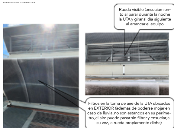
Fuente: Air Quality Protescan. Vista frontal de instalación real de una UTA con recuperador rotativo, de rueda
