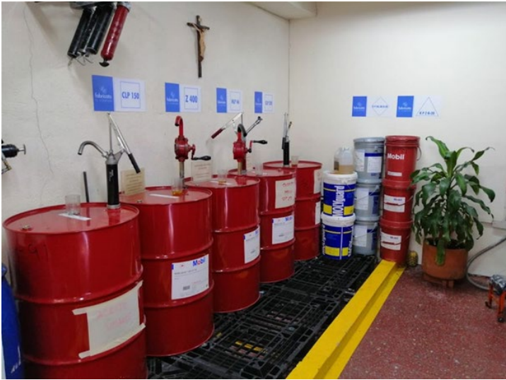
Fig.17. Identificación del cuarto de lubricación bajo norma DIN 51502. Fuente propia.
