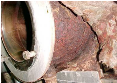
Figura 6. Corrosión bajo aislamiento.
