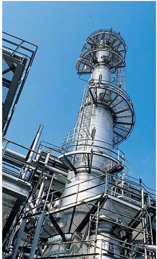
Fig.1. Columna de fraccionamiento
