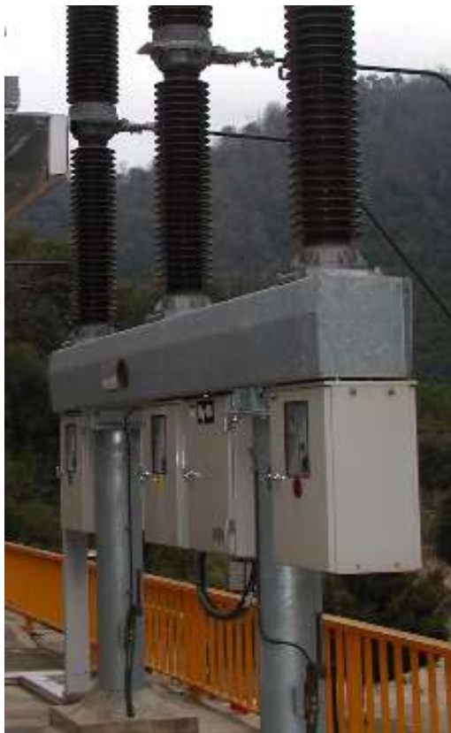
Fotografía 2. Interruptor de potencia de grupo hidroeléctrico (Fuente: Enel Green Power-Endesa Generación).
