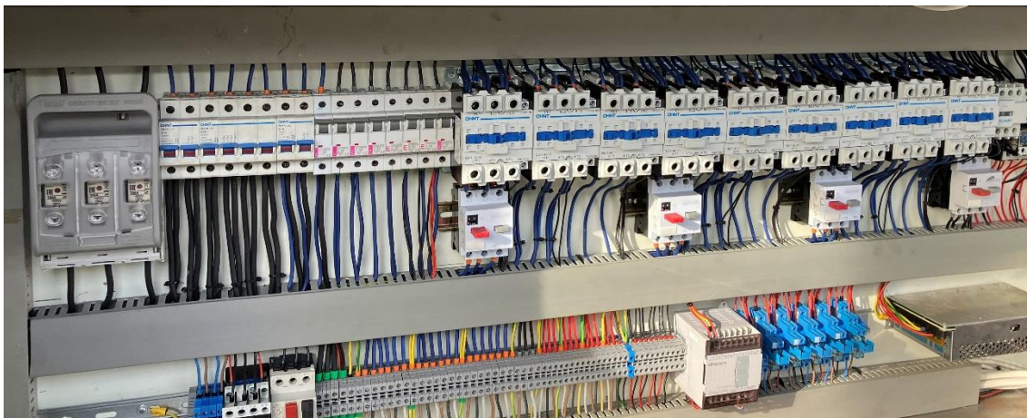
Слика 3.23. Контактори и релеји који су инсталирани у постројењу.
