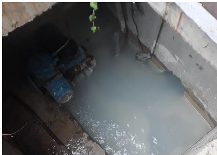
Слика 3.18. Мерач протока воде који је инсталиран у постројењу.
