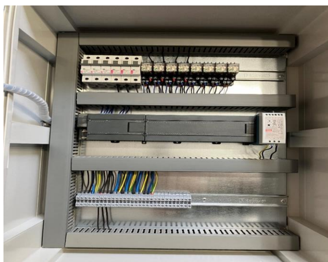
Слика 3.26. PLC који је инсталиран у постројењу.
