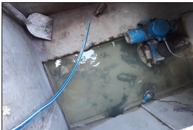
Слика 3.13. Испуштање прерађене воде у реципијент.
