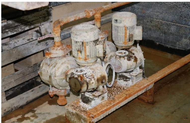
Слика 3.32. Приказ оштећене опреме након плављења постројења.
