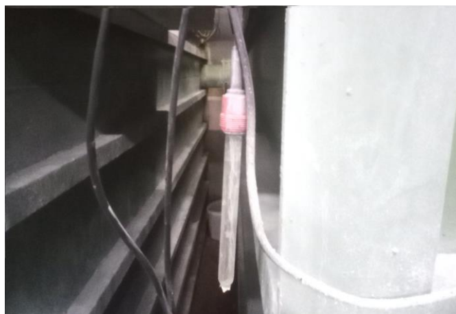
Слика 3.14. Pt-100 сензор који је инсталиран у постројењу.
