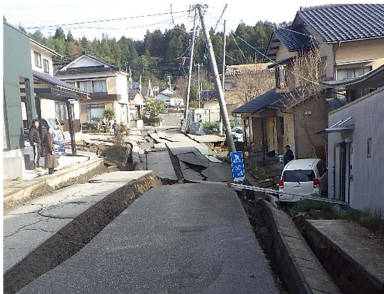
大規模盛土造成地の地すべり（藤波）
