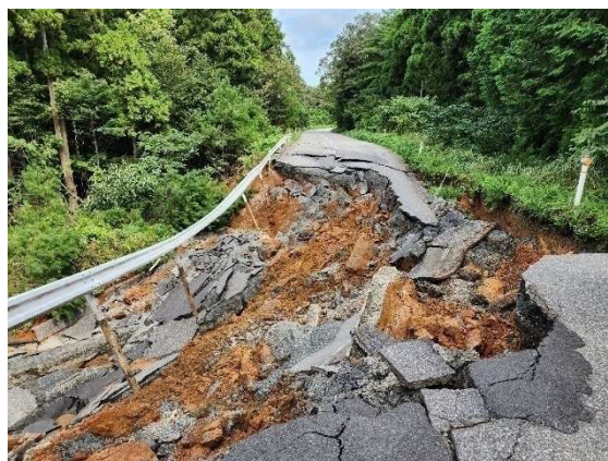
道路の崩壊（北河内）
