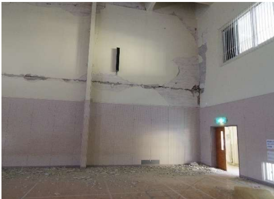
宇出津小学校体育館壁の崩落
