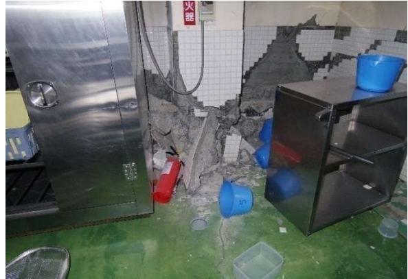
松波小学校調理室の柱の破損
