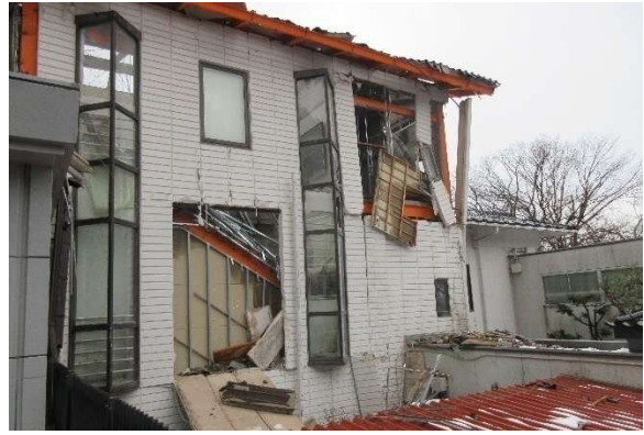
全壊した国民宿舎能登やなぎだ荘別館
