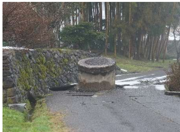
液状化によるマンホールの隆起（鴨川）
