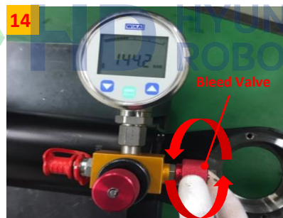
慢慢的对Bleed Valve进行反复Open/Close, 以希望的压力设定。
