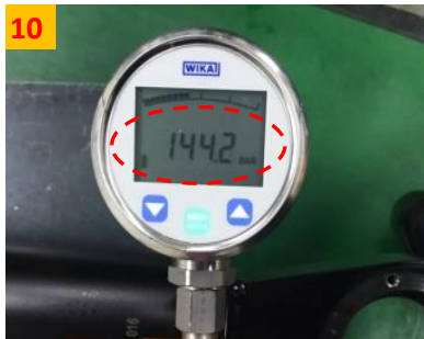
到达设定压力时, Close序号9号的Air Valve, 使Booster(S86JN)停止。
