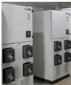
Figura 9 – Sistema de compensação estática de energia reativa instalado
