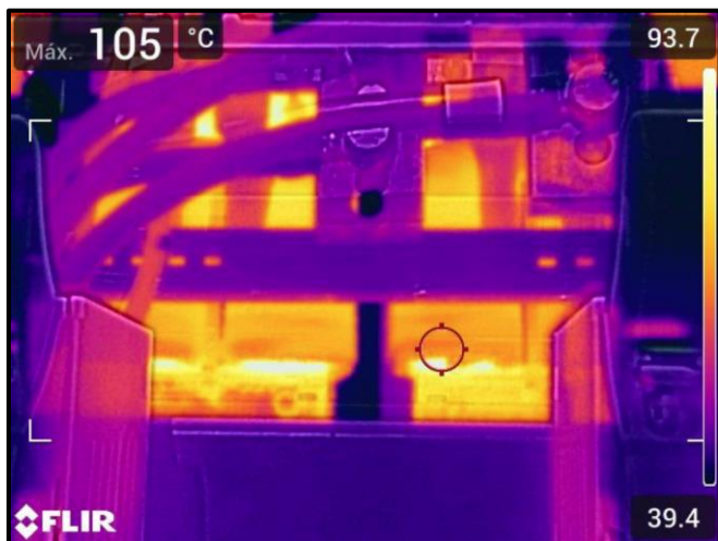
Figura 17 – Imagem térmica nos reatores dos filtros harmônicos passivos de 5ª ordem.
