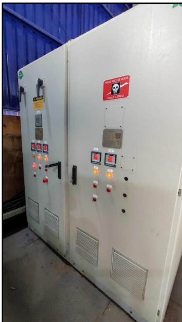
Figura 16 – Registro fotográfico do desligamento dos filtros harmônicos pela proteção de distorção harmônica.
