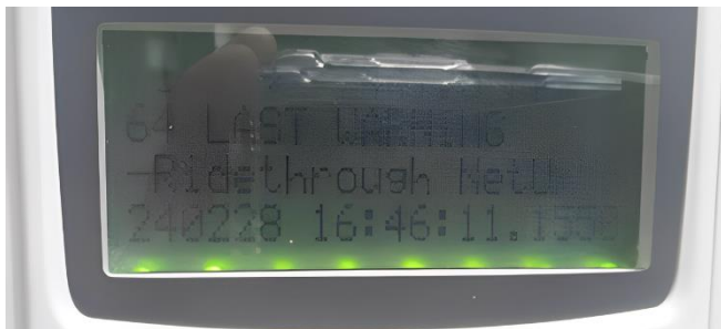
Figura 5 – Registro Fotográfico do Inversor de Frequência 331FN400U01.
