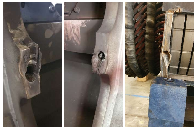
Fig. 4 Sistema de fixação do estator e carcaça danificado.
