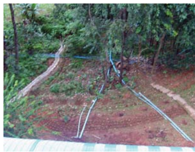
Trinkwasser Leitungen hinter dem Hotel
