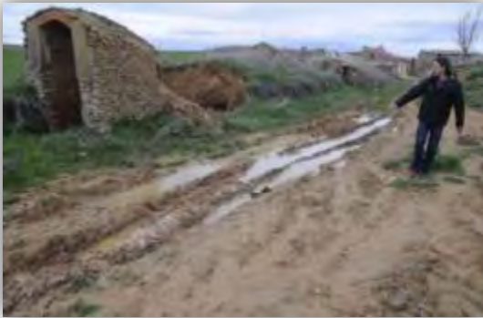
Un vecino muestra el estado de los accesos a las bodegas de la localidad.
